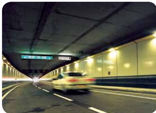
隧道内的空气净化和排烟系统
